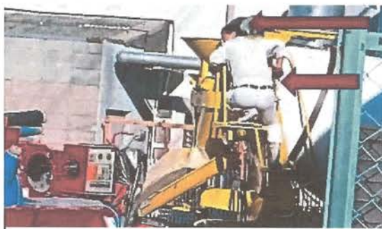
高所作業においてノーヘルメット・ノー安全帯
